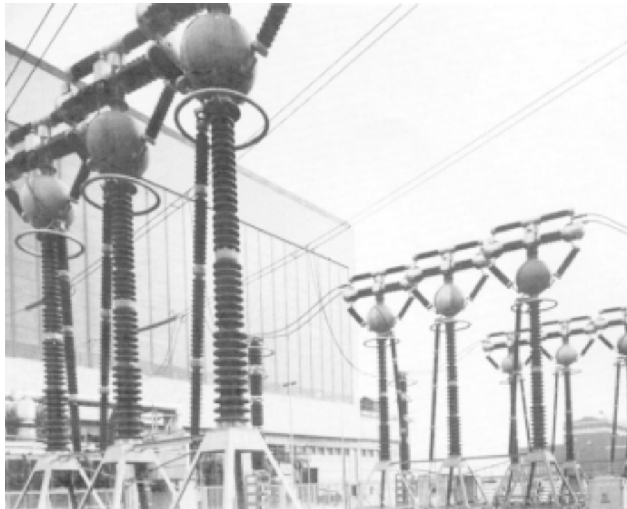
Fig. 13 : disjoncteur à air comprimé 420 kV.
